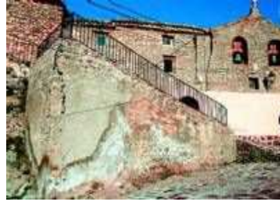
El muro actual amenaza derrumbe.
