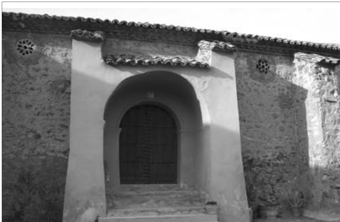
La cubierta del tejado de la ermita de San Roque está derrumbada en gran parte
