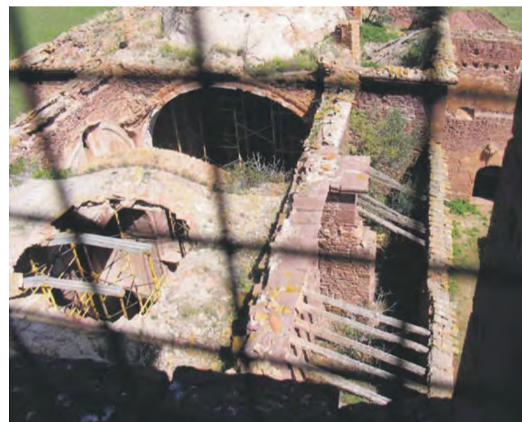
Vista desde el campanario del estado de la cubierta por el exterior.
