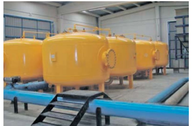
Sistema de Omnifiltraciones situado en las instalaciones de la ETAP.
