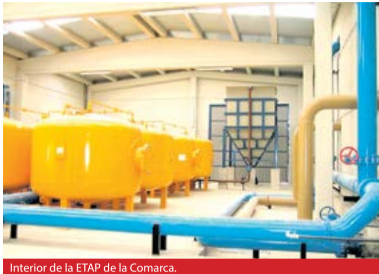
Interior de la ETAP de la Comarca.
