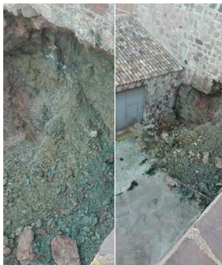
Fotos de los desprendimientos.
