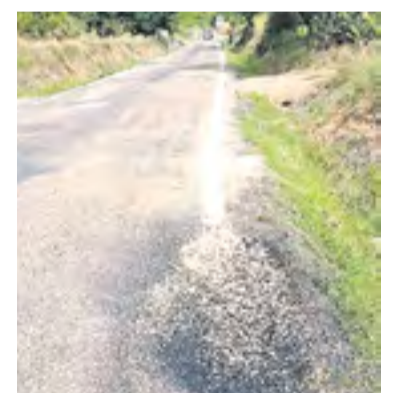
Estado del firme.
