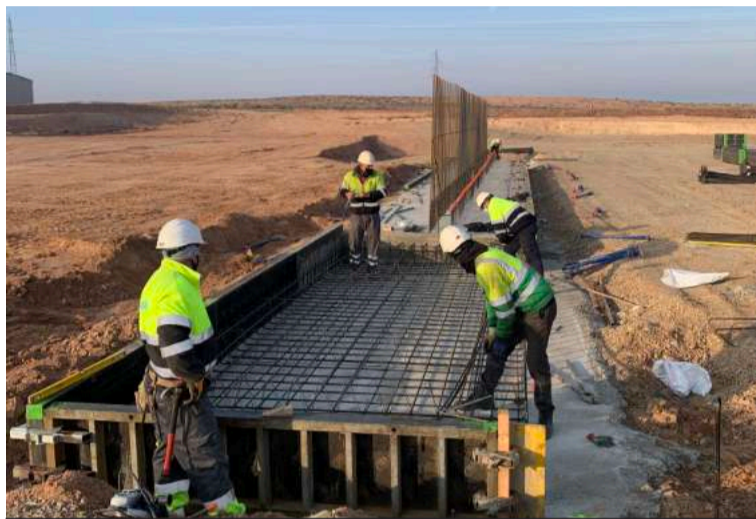
Planta de transferencia del servicio Ecoprovincia de Quinto.
