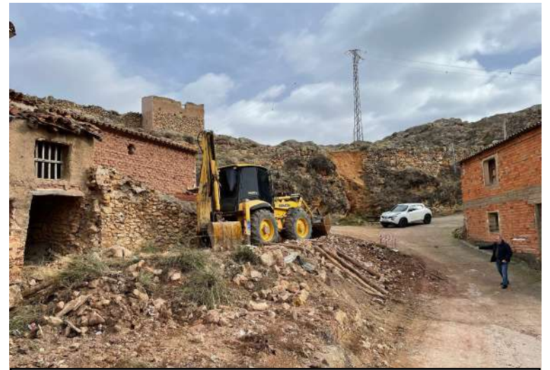
Obras para la mejora a los accesos del Castillo de Mesones de Isuela.
