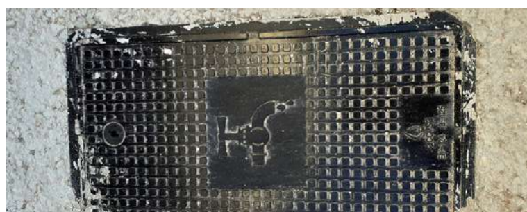
Contador de agua.
