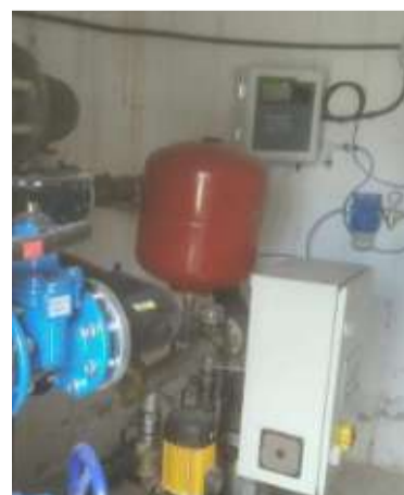
Sistema para la detección y control de fugas.
