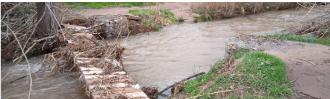
Daños producidos por las riadas.
