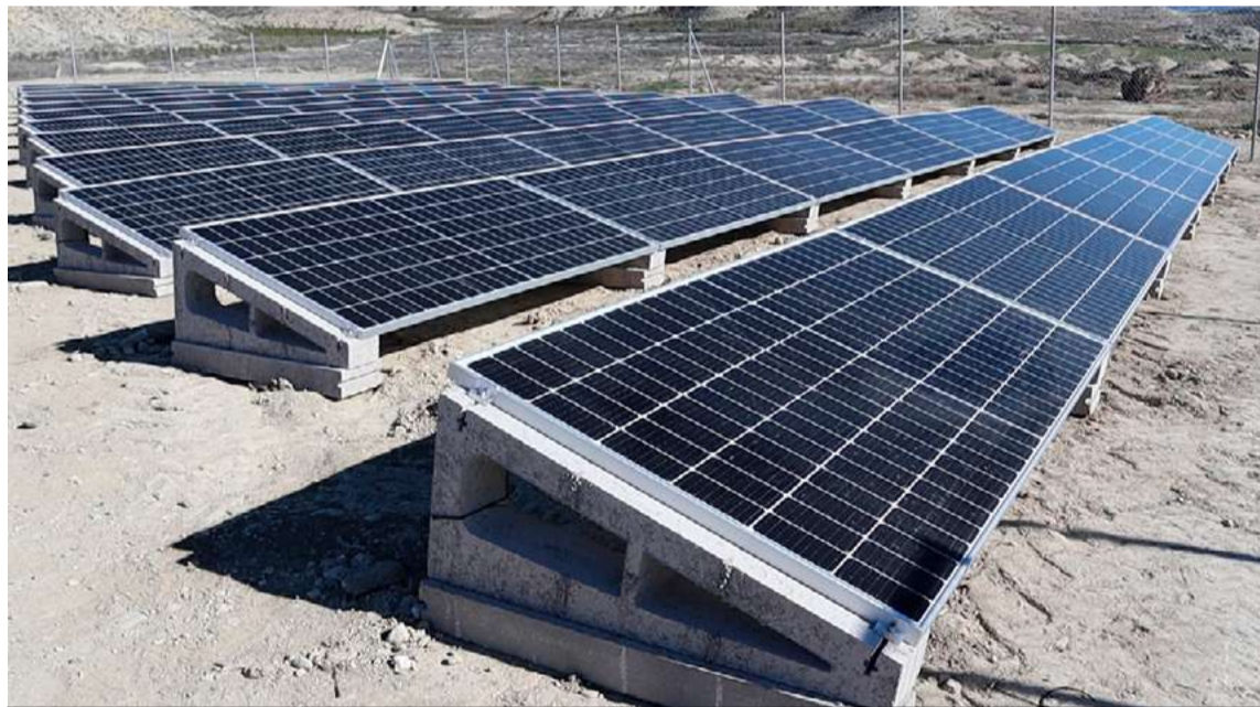
Una de las plantas municipales de autoconsumo energético que ya están en marcha en los municipios de la provincia de Zaragoza. DIPUTACIÓN DE ZARAGOZA
